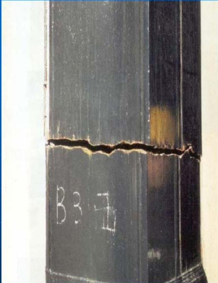
Kobe, 1995. Fractura de una columna de acero (tubular cuadrado)
